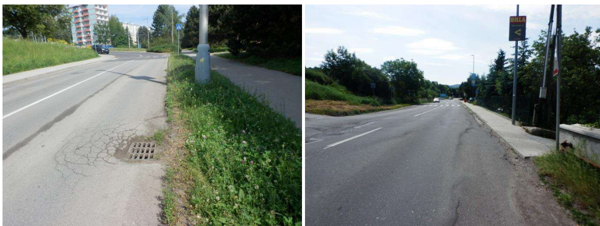
Obr. 4-23 Poklesnutá kanalizačná vpusť a poruchy vozovky v jazdnej stope cyklistov
