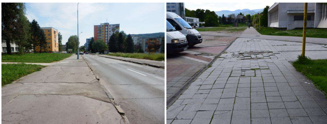
Obr. 4-25 Nerovnosti a trhliny na chodníkoch
