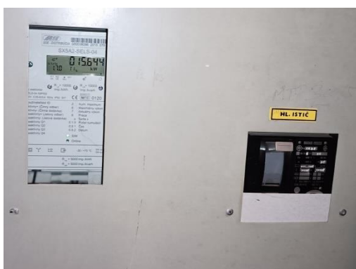
Obrázok 27. Fakturačný elektromer – byt školníka, rozvodňa
