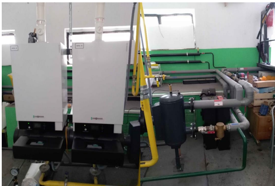
Obrázok 10. Kotle a vybavenie kotolne
