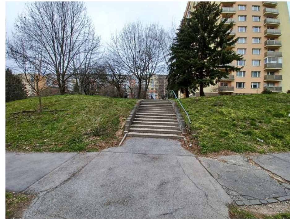
NEBEZPEČNÉ A ZLE TECHNICKÉ RIEŠENIE A REALIZÁCIA NIEKTORÝCH SCHODÍSK
