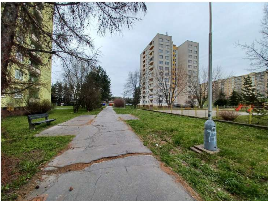
NEDOSTATOČNÁ ŠÍRKA HLAVNÉHO PEŠIEHO ŤAHU CEZ SÍDLISKO A ZLÝ TECHNICKÝ STAV CHODNÍKOV
