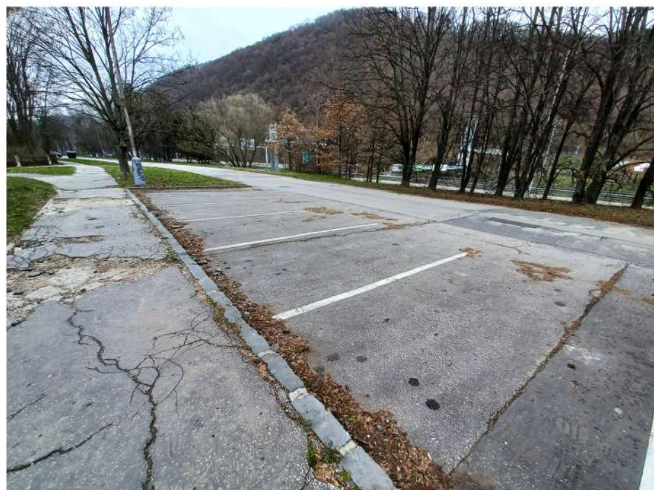
NEPRIEPUSTNÝ POVRCH PARKOVACÍCH PLOCH A ZLÝ TECHNICKÝ STAV
