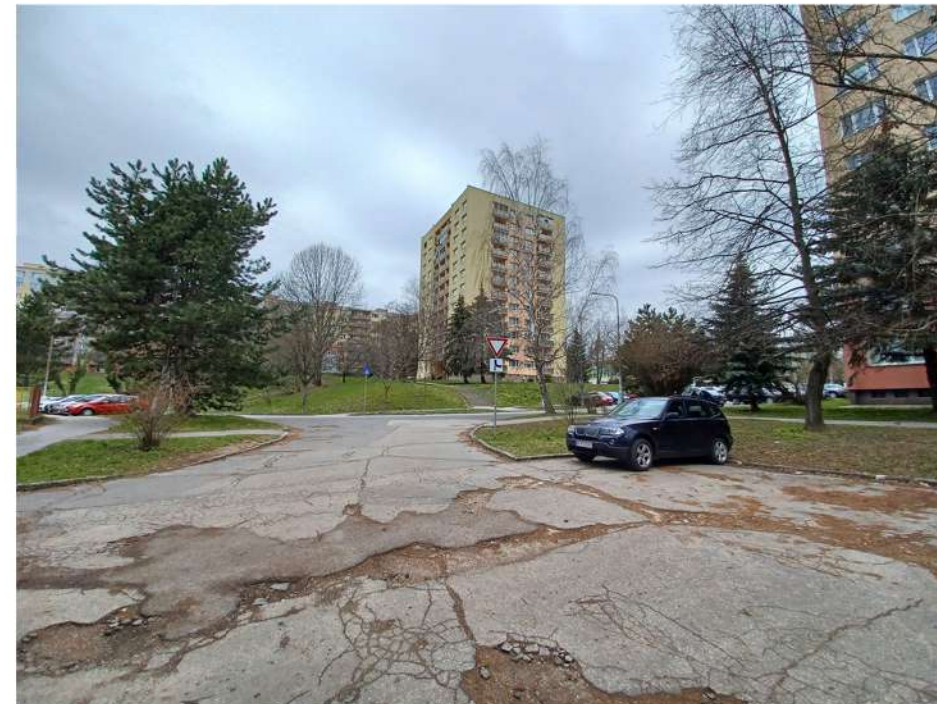
NEVYHOVUJÚCI TECHNICKÝ STAV KOMUNIKÁCIÍ
