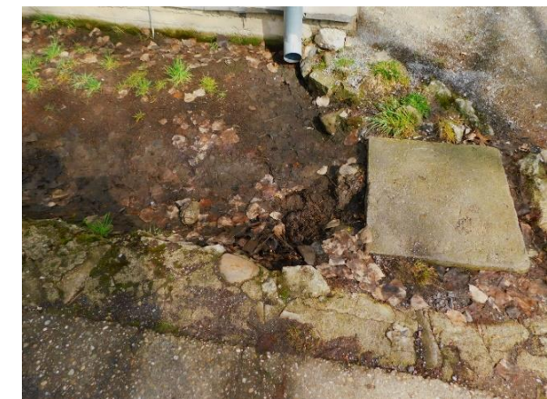
Odtok z garáží do nefunkčného žľabu
