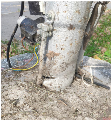
Obr. 9 Deravý stožiar pod pätkou
