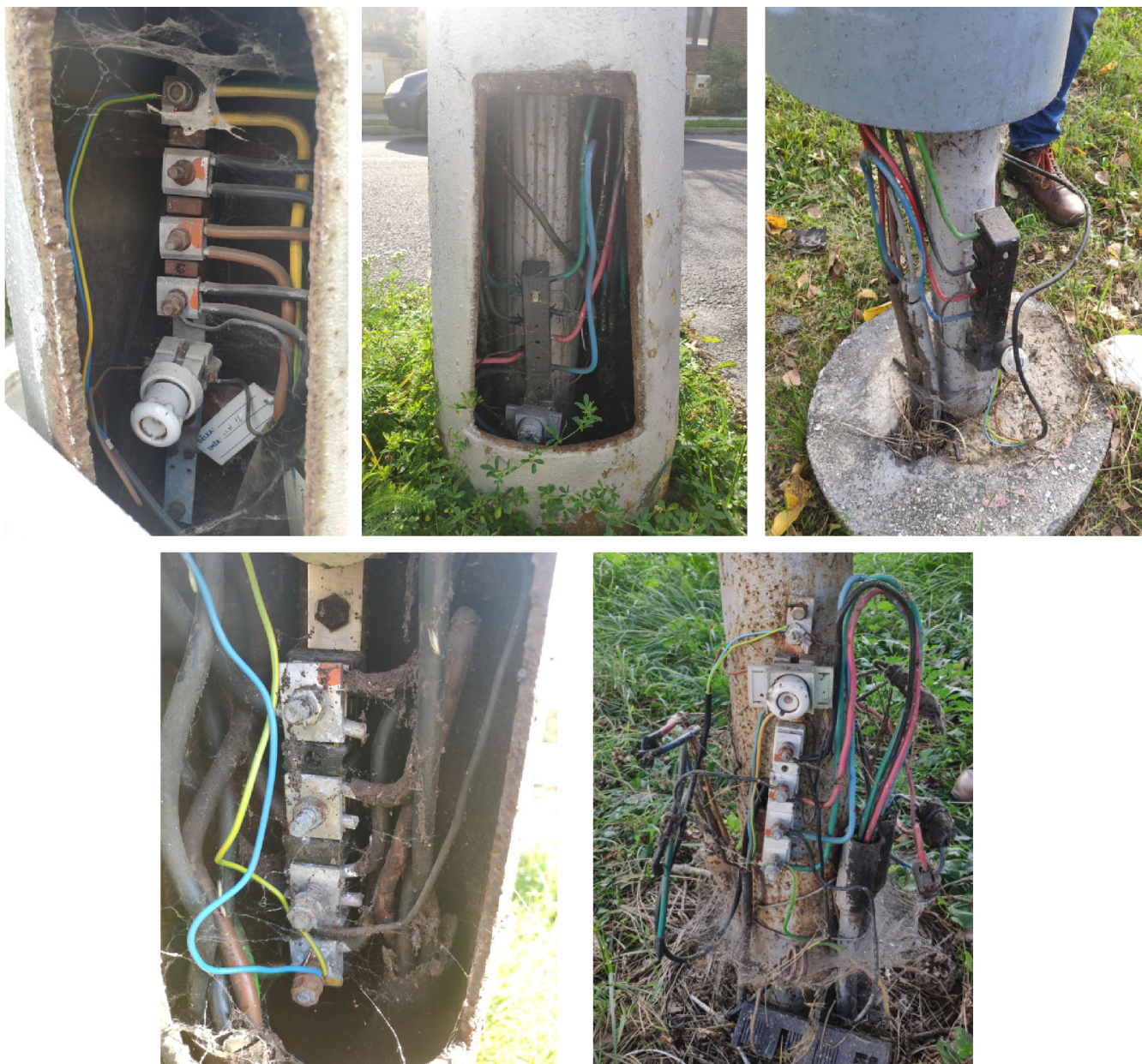
Obr. 10 Neuzavretá stožiarová elektrovýzbroj, skorodované, nestabilné krytie elektrovýzbroja, voľne dostupné živé časti, zoxidované kontakty - Ulica Nové kalište, Wolkerova, Spojová, Jazmínová, Internátna
