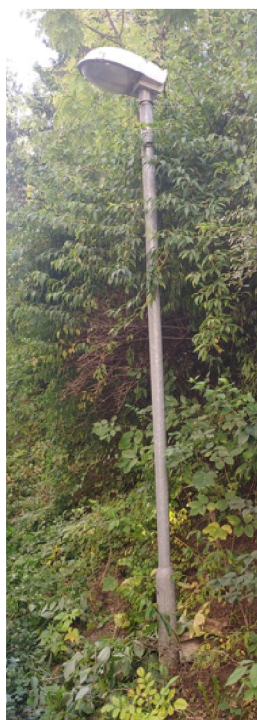
Pozinkovaný oceľový stožiar Ulica Švermova 1-17
