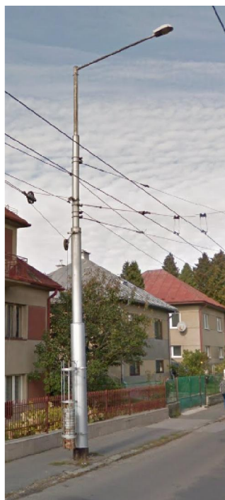
Trakčný oceľový stožiar Ulica Nové Kalište
