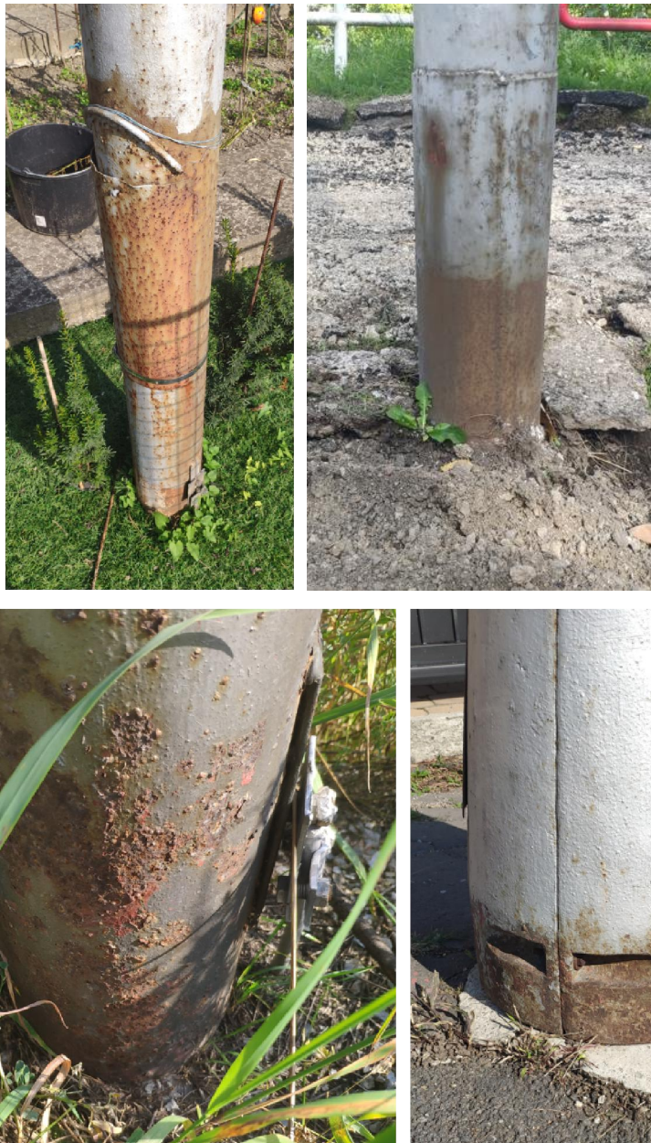
Obr. 7 Silne skorodované stožiare na rôznych miestach - hrozba pádu stožiara
