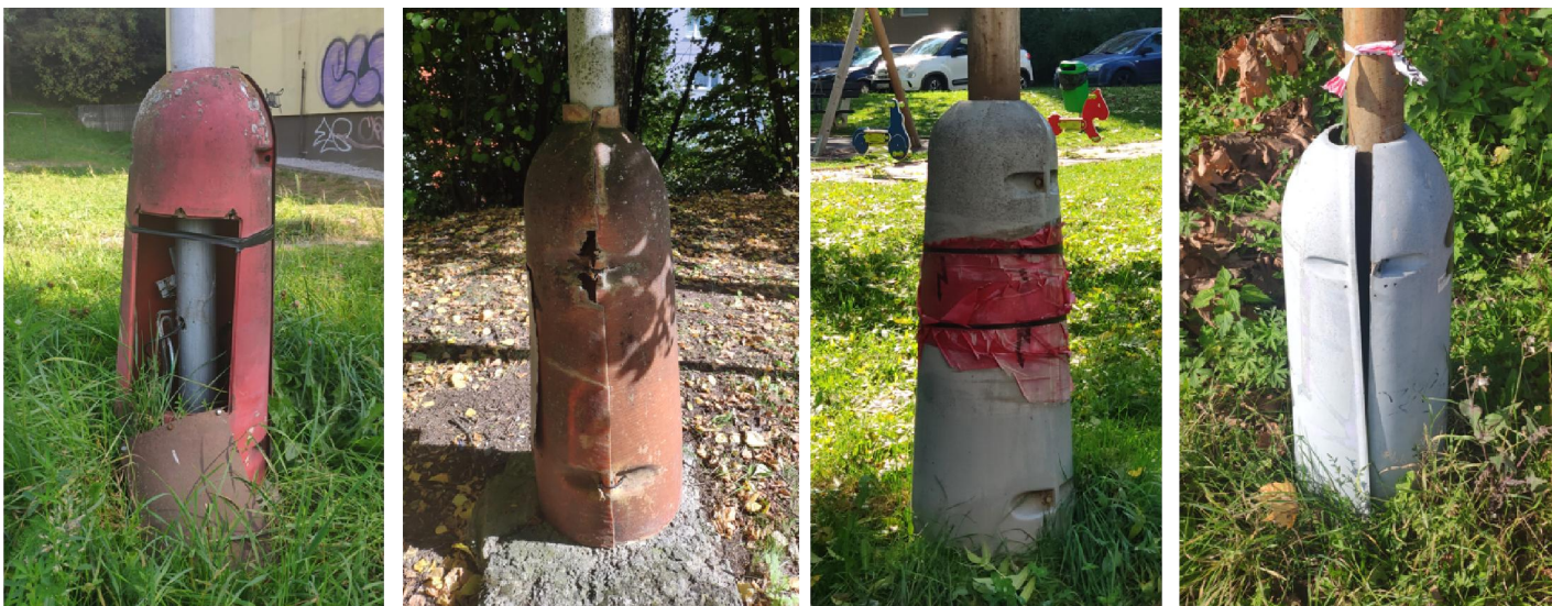
Obr. 8 Pätky na Ulici Spojová, Jilemnického, Tajovského – Prepáskovaná, rozbitá pätky stožiaru
