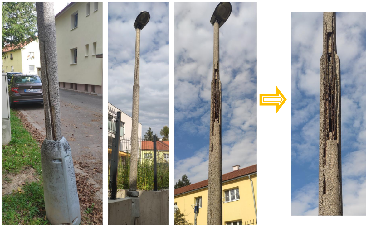
Obr. 11 Tenké betónové stožiare v havarijnom stave – Ulica Jilemnického – vnútroblok, Internátna - vnútroblok
